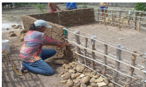
Figura 3 – Tanque de barro
